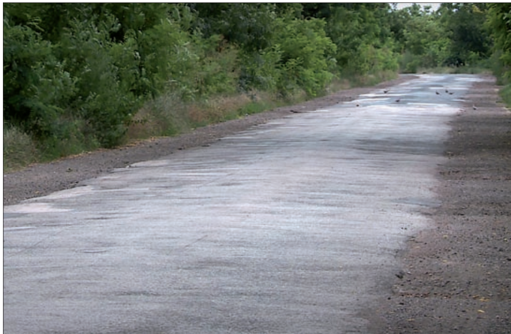
A szakaszon nagy a teherforgalom, az út keskeny, sok a kátyú
