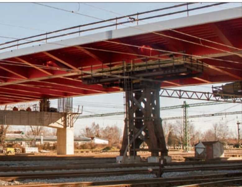
látványosan halad a munka. Mint azt Loppert Dánieltől, a Nemzeti Közlekedéstudományi Rt. igazgatójától megtudtuk, a felüljáró forgalomba helyezése legkésőbb 2015 nyáron várható, a közlekedés is biztosított lesz.
