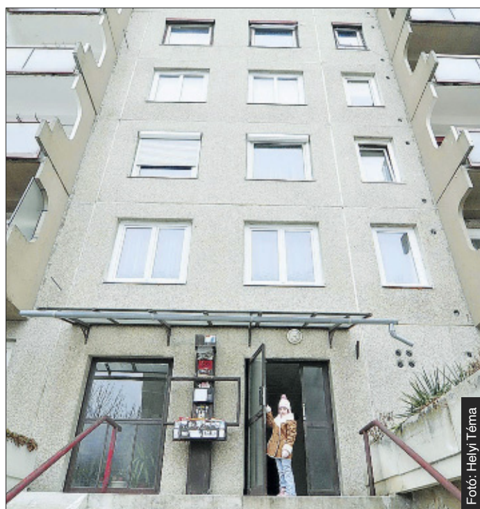
A kötések problematikusak, az időjárás hatásaitól, a korróziótól már előregedtek
