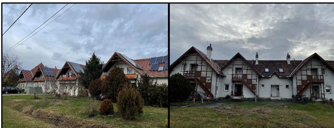
98. ábra: A Franklin utcai szociális bérlakások utcafrontos és hátsó homlokzata (felújított állapot) - 2021 december 2. terepbejárás
